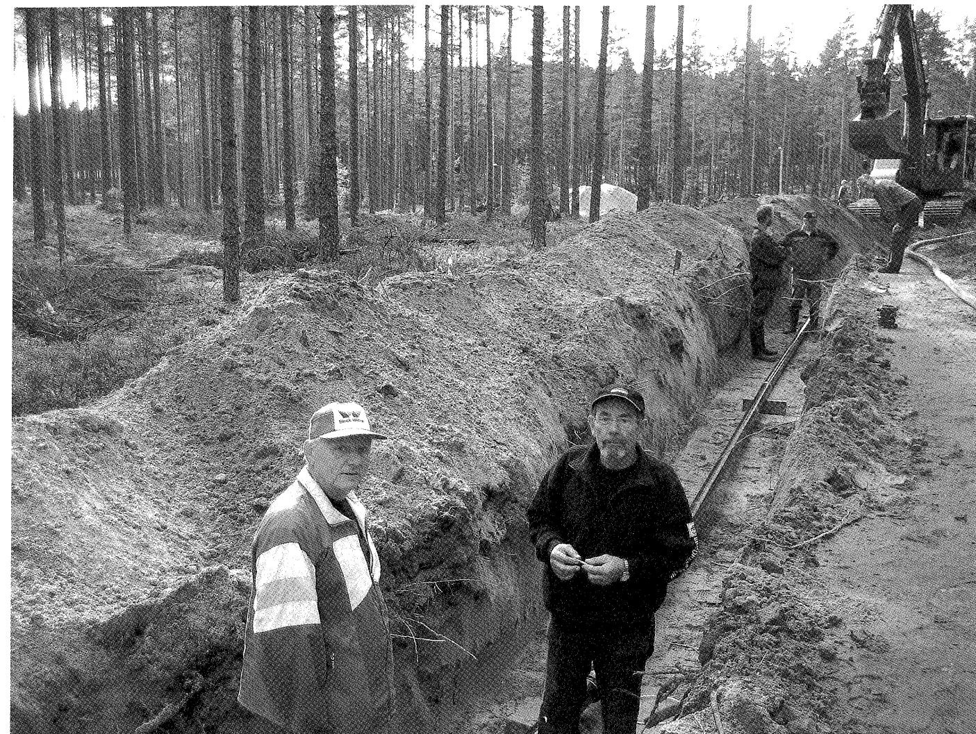
Dugnad på Liermoen for å få på plass rørgata for luft og vann til det blivende kunstsnøanlegget. Rolf Engen og Trond Rung tar en pust i bakken.
